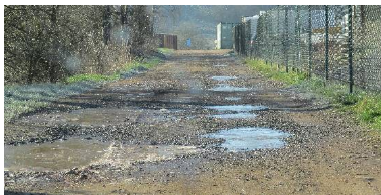
Snímek navazující komunikace: QBERRY s.r.o. na p. p. 108/14 k. ú. Volanov
